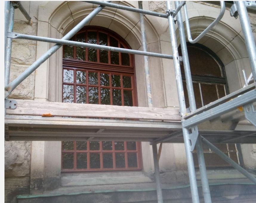
Außen: Farbe ist abzdunkeln
